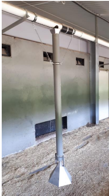
Abb. 35: Ansicht eines im Pilotbetrieb installierten Fallrohres mit Prallvorrichtung an einer der Auswurföffnungen der automatischen Beschäftigungsanlage
