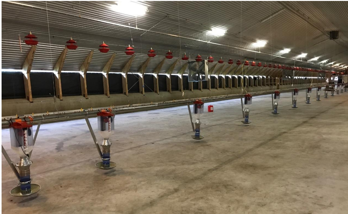
Abb. 52: Blick in den Stall auf Betrieb 5 nach Einbau des automatischen Anlagensystems (Bildquelle Big Dutchman)
