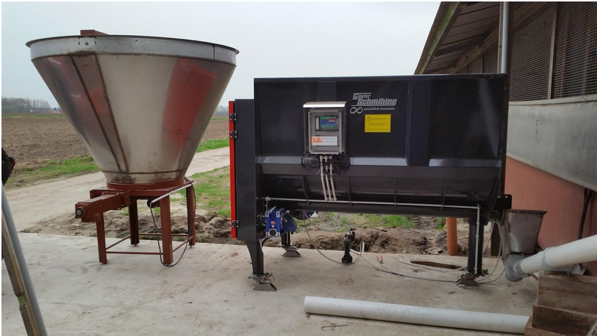
Abb. 88: Annahme (links) und Mischer (rechts) vor Inbetriebnahme des Anlagensystem, nach Aufnahme des Bildes wurde noch ein Zuführer zwischen Annahme und Mischer montiert, der einen automatischen Transport des Materials mittels Spiralförderung aus der Annahme in den Mischer ermöglicht (Bildquelle: Schmidt)
